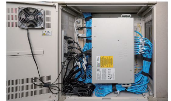
臨床教育研究棟では300本以上のLANの再配線を実施、スイッチやケーブルは教員居室からEPSへ移設
