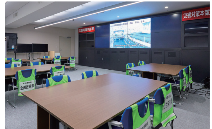
庁舎内にある災害対策本部室。リアルタイム情報を基に意思決定が可能な環境を整備
