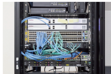
学内サーバー基盤の配線。ネットワーク構築では情報セキュリティ対策と安定した通信を重視
